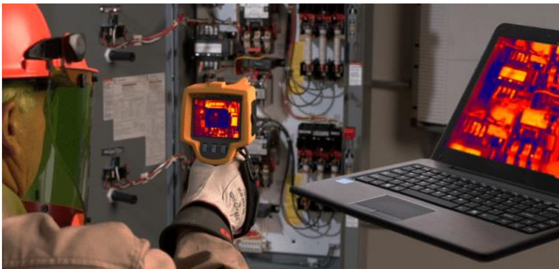
Рисунок 20. Пример проведения тепловизионного контроля электрошкафа
